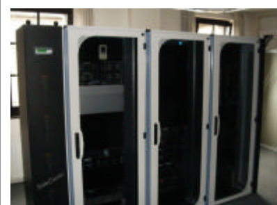
Bild 2: 3 Racks mit 2 SideCoolern
